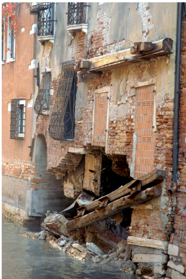
Crollo del muro inferiore di un edificio a San Barnaba, 2003. L'umidità causata dall'innalzamento del livello dell'acqua porta al deperimento sempre più rapido e violento del patrimonio architettonico.
